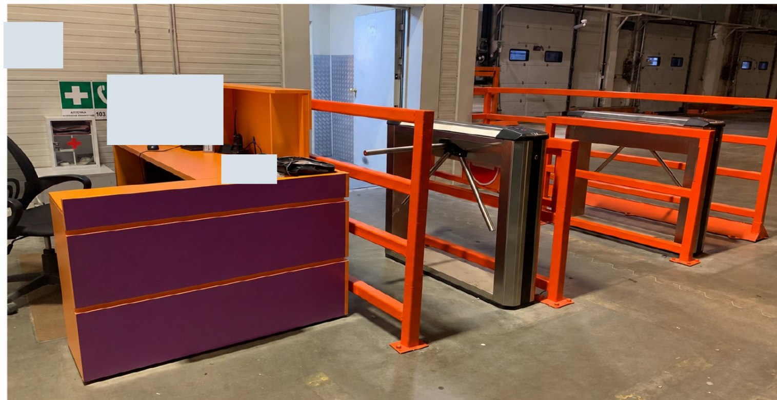
Фото установленной стойки охраны и турникетов.
